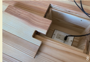
無垢の床材を最大限活用するために造作したオリジナルのフロアコンセント。
