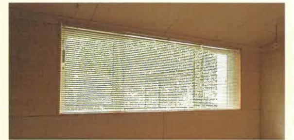
↑ 2階に設けた室内物干し部屋。FIX+縦出しのウィンドキャッチャーが効率良く風を流し、さらに室内に設けた換気扇とのダブル効果で籠った湿気を排出してくれます。
